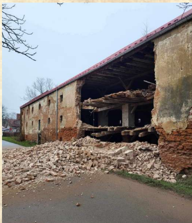
Ruina starego ceglanego spichlerza w Radłowie
